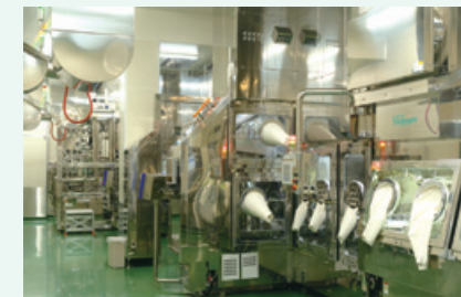
岩城製薬佐倉工場 高薬理活性注射剤製造設備
